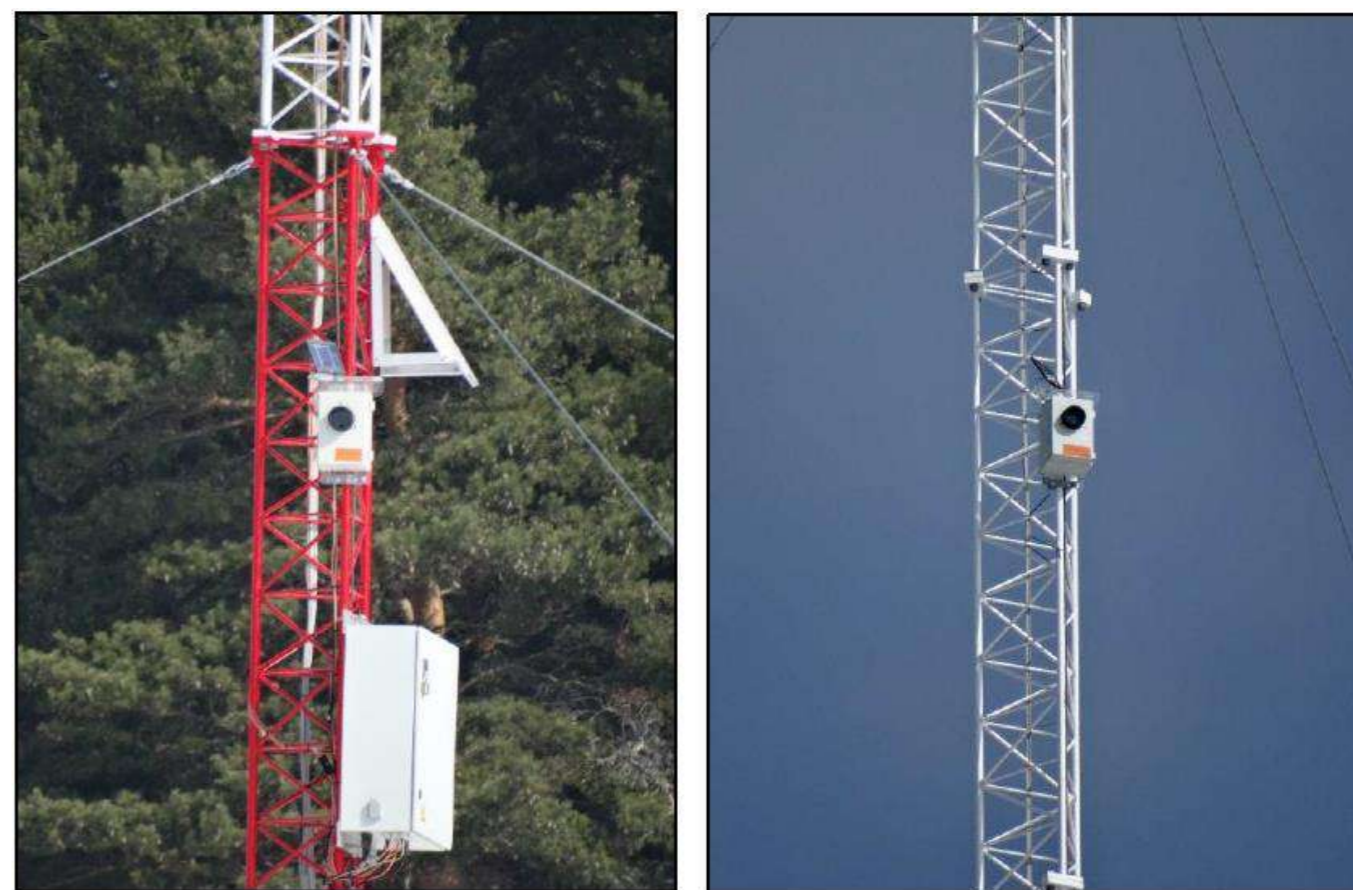
Photographie 1 : Clichés du positionnement d'une BCBox sur mât de mesure (Source : EXEN)
